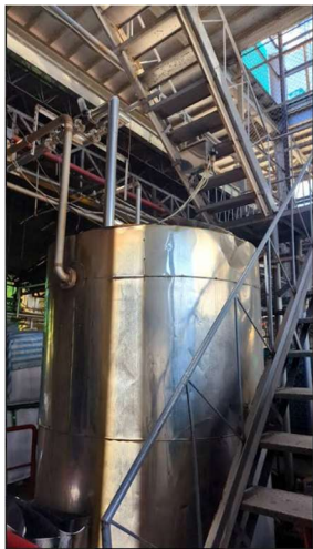
蒸氣分配器冷凝水回收
