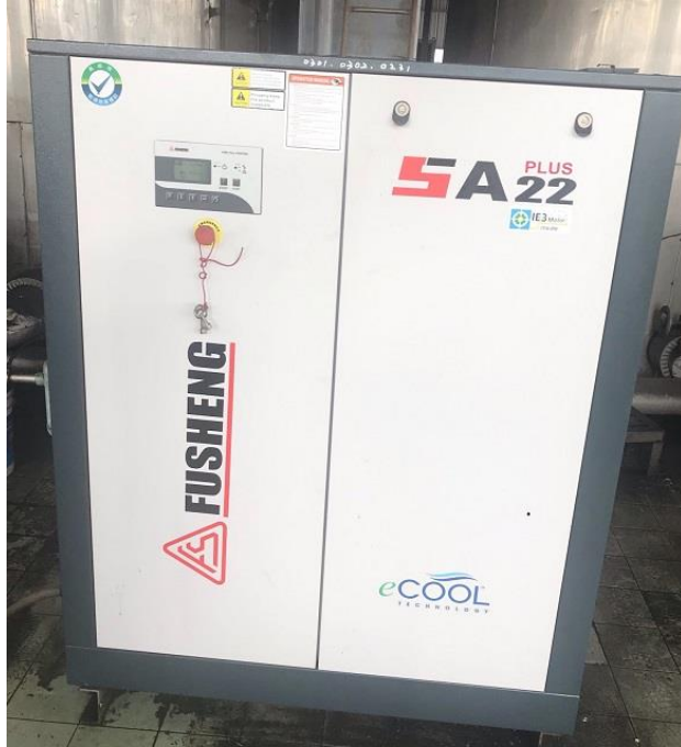
高效率空壓機
