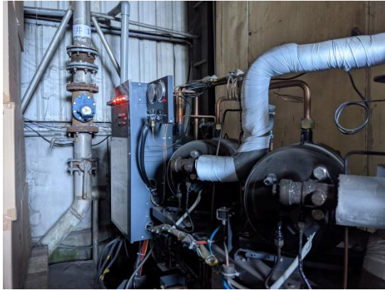
冷凍庫壓縮機
