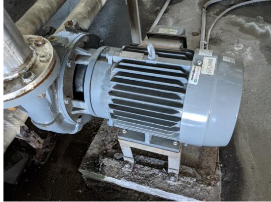
製程冷卻水循環泵
